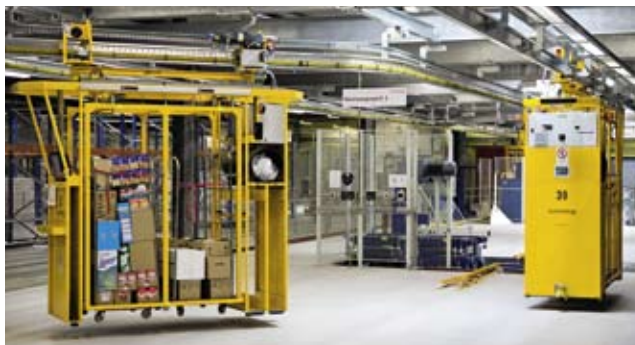
CaddyPick basiert auf einer automatisch gesteuerten Elektrohängebahn und ermöglicht die effiziente Befüllung von filialgerechten Transporteinheiten.
