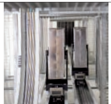
Schienenführung in speziellem Schacht
