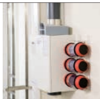
Sende-/Empfangsstation einer Rohrpostanlage mit Speicherfunktion
